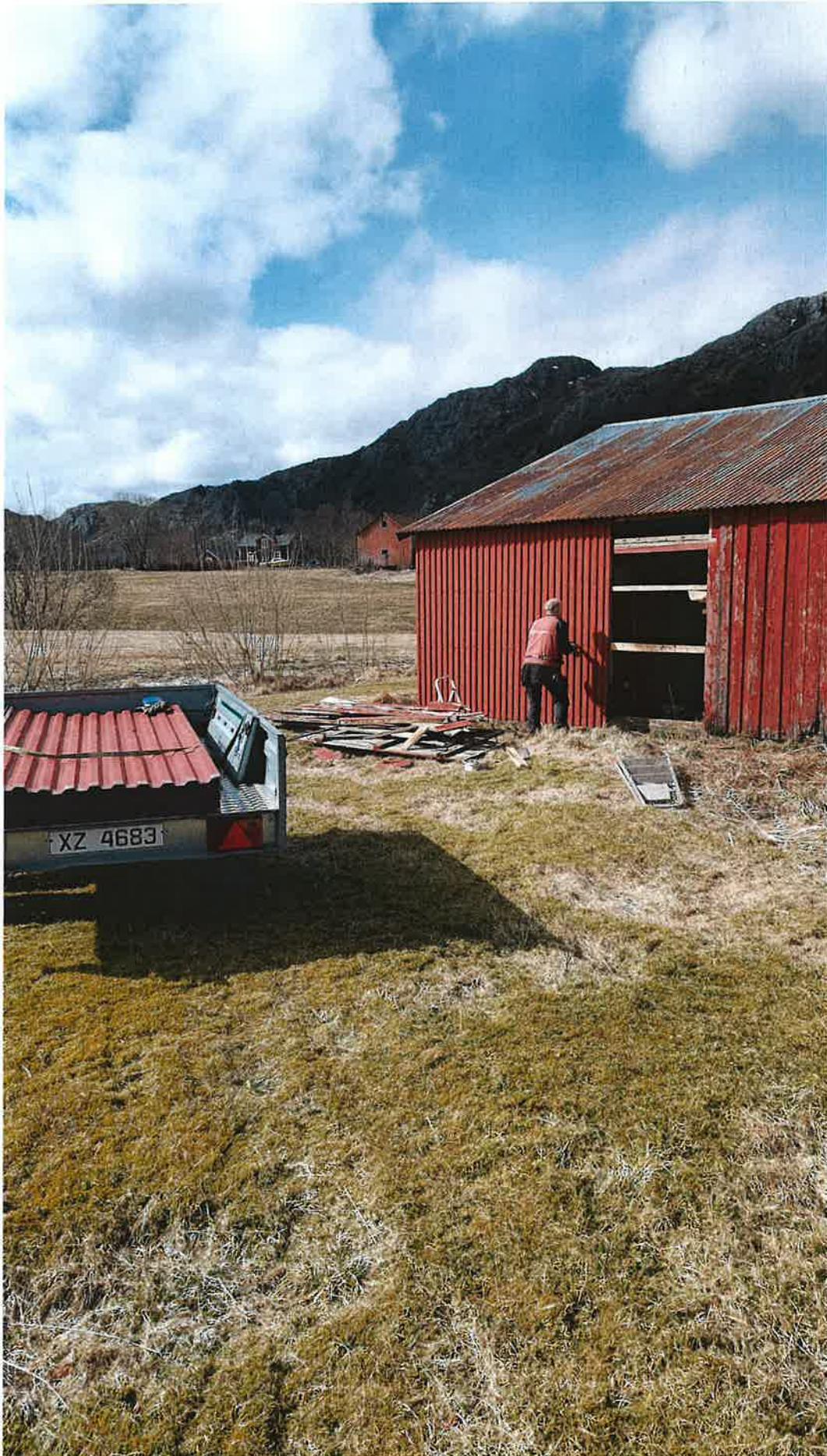
FJØS/LÅVE SØR. PORT OG VEGG SKIFTES UT.
